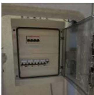
Quadro di protezione interno IP65
