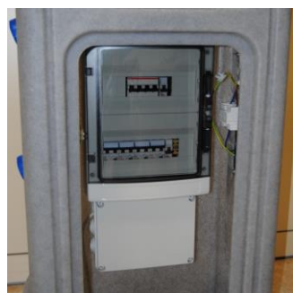
Quadro di protezione interno IP65
