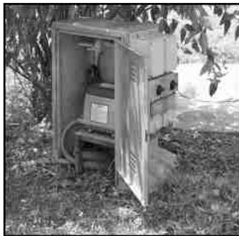
ESEMPIO DI LOCALE TECNICO
