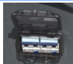
Interruttori posizionati su entrambi i lati
